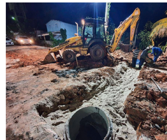
Trabalho noturno para pavimentação com calçada, meio-fio e sarjeta em Santo Antônio do Itá
