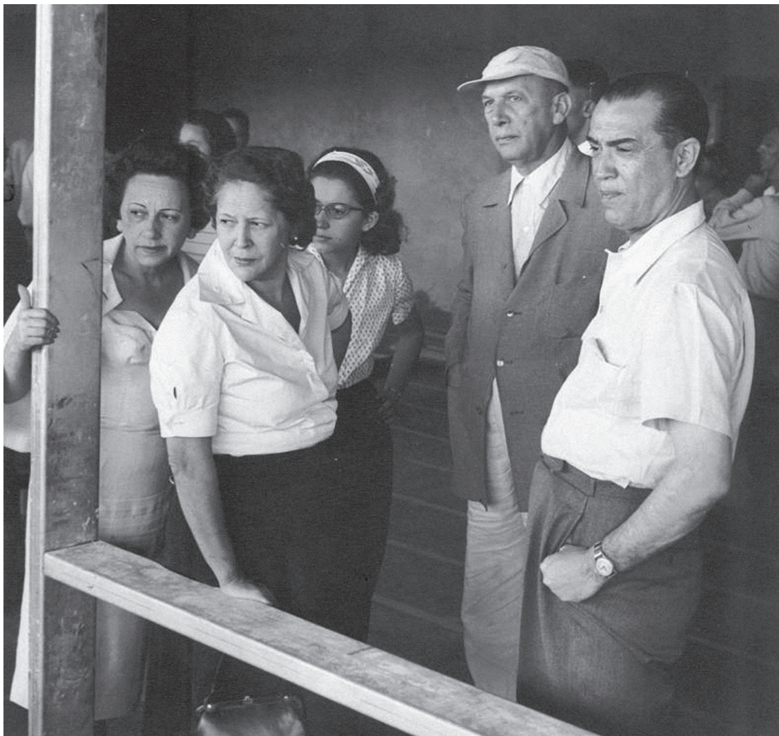
Presidente Juscelino Kubitschek e família visitam as obras do Palácio da Alvorada (1958).
