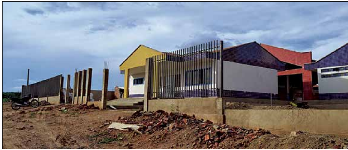
Construção paralisada de creche no Piauí: o governo federal já repassou R$ 1,4 milhão para a obra, iniciada em 2012
